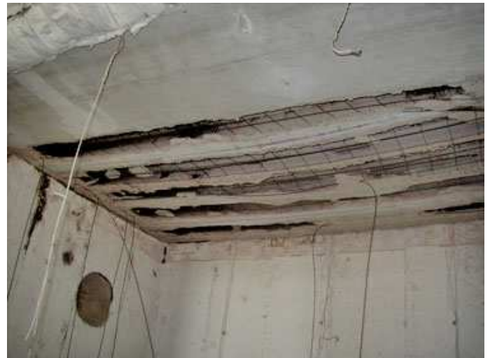
Figura 32.18. Daños causados por el fuego en un forjado de hormigón.
