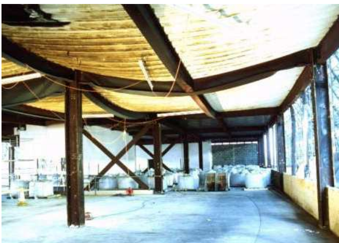
Figura 32.17. Algunos ejemplo de estructuras de acero sin proteger afectadas por el fuego.
