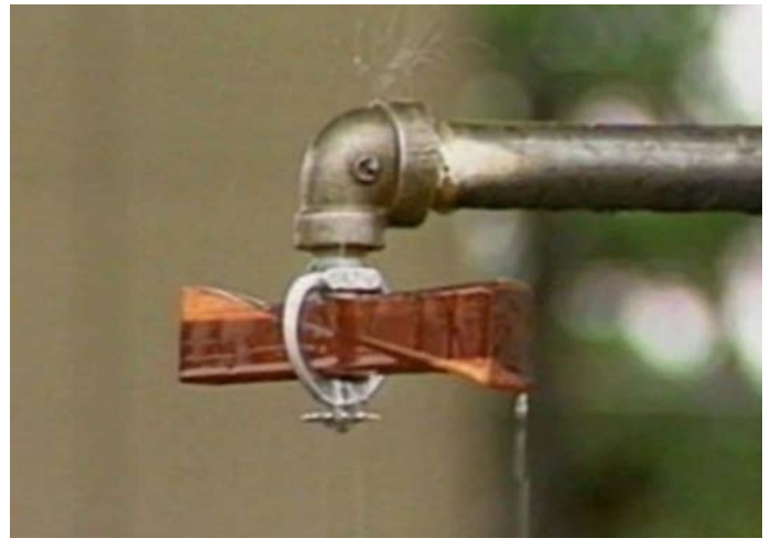
Figura 13.29. Los rociadores disparados pueden taponarse usando cuñas, después de controlar el incendio.
