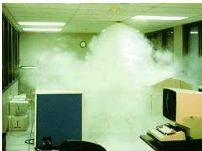
Figura 7.22. Instalación fija de extinción por gas en el momento de su descarga.
